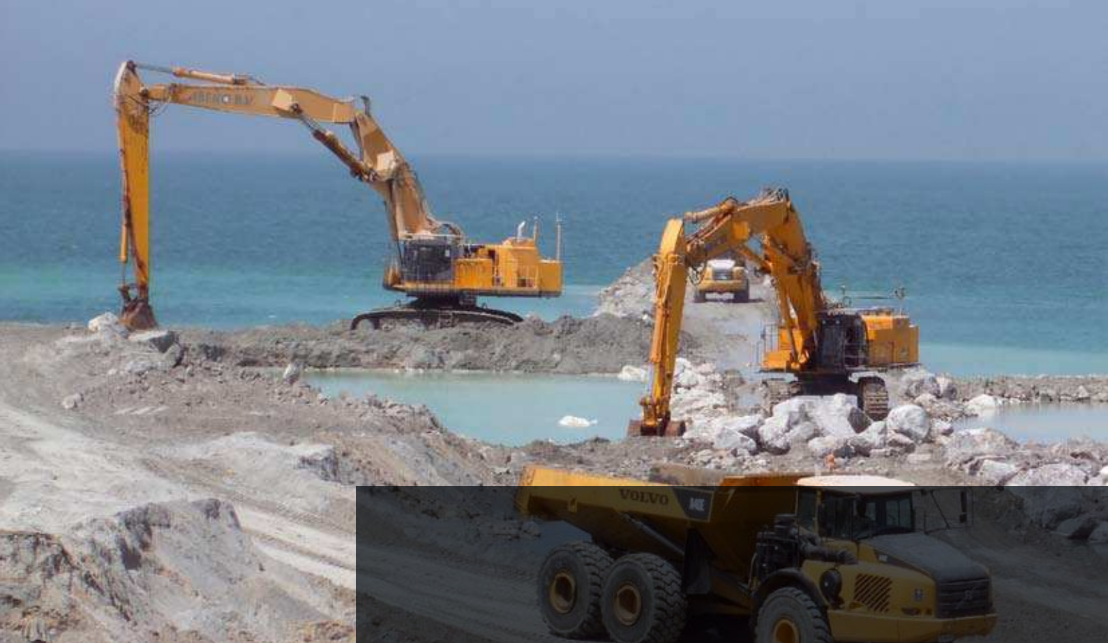
DEMOLICIÓN DE ROMPEOLAS VIEJO Y CONSTRUCCIÓN DE ROMPEOLAS NUEVO EN DUBAI (UAE)
